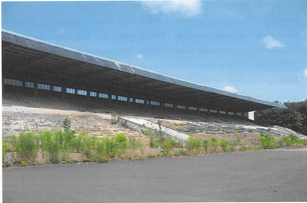
Widok wyłączonej z użytkowania, z uwagi na zły stan techniczny, trybuny III na zdjęciu wykonanym w lipcu 2008 r.
