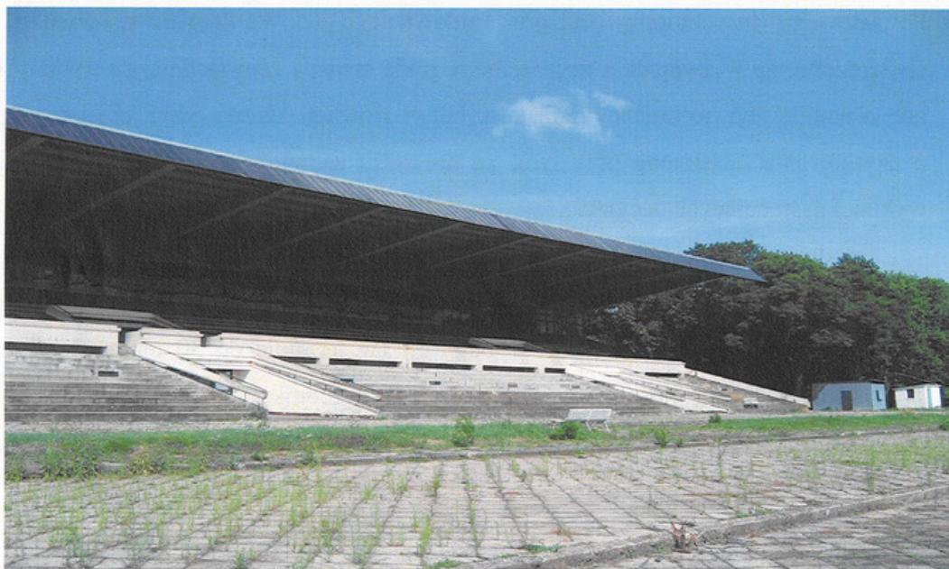
Widok trybuny II, której widownia z uwagi na zły stan techniczny została wyłączona z użytkowania – zdjęcie wykonane zostało w lipcu 2008 r.
